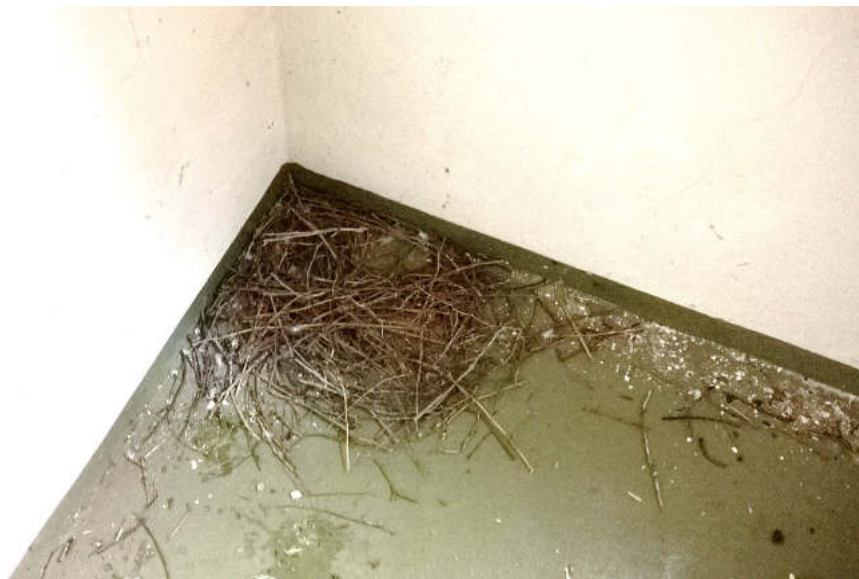
Abb. 5: Altes Haustaubennest im kontrollierten Gebäude (26. Juli 2017, Foto: J. Weipert)
