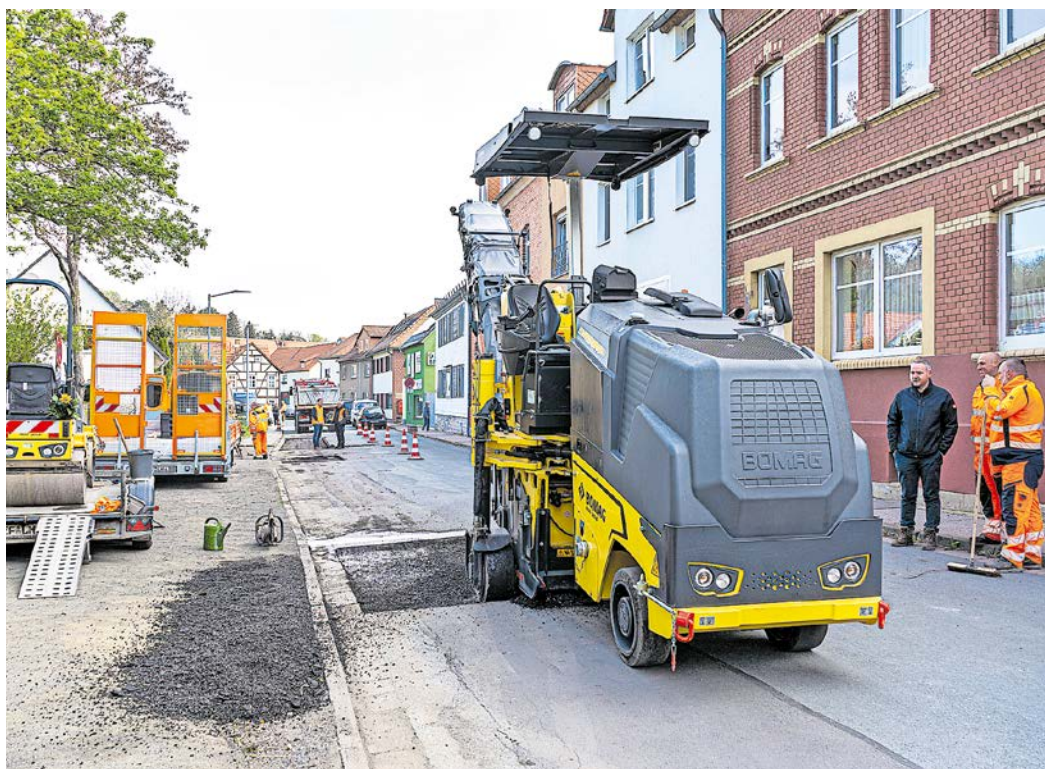
Die Asphaltfräse ermöglicht den Mitarbeitern des Straßenbetriebshofs ein schnelleres und effizienteres Arbeiten.
