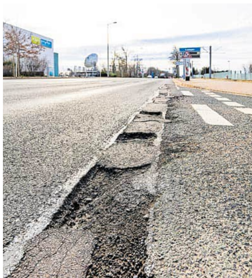
Eine Überalterung des Asphalts führt in der Gothaer Straße zu Schäden am Belag und zu Substanzverlust.
