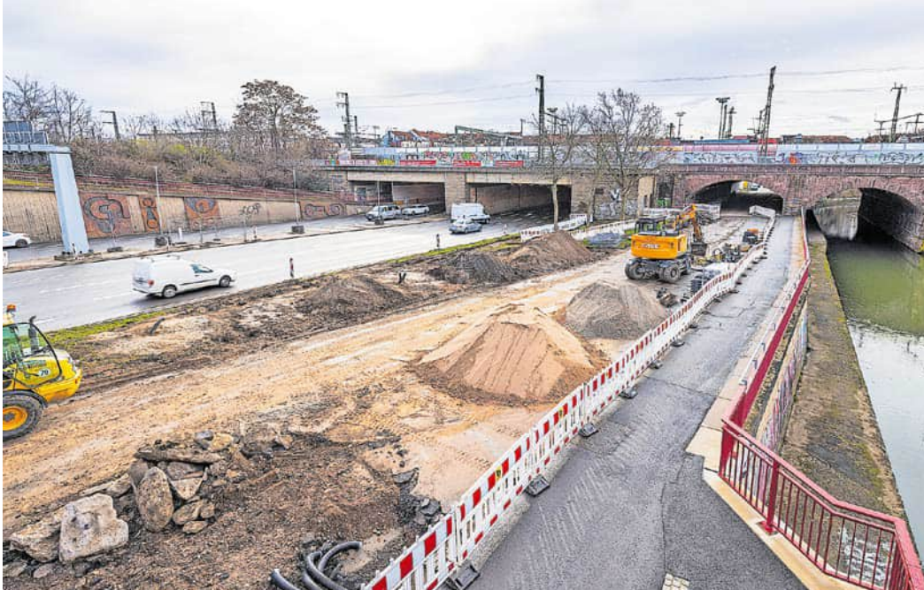
Seit Jahren wird am Schmidtstedter Knoten gebaut. Aktuell entsteht in der westlichen Tunnelröhre der Haltepunkt für die Fernbusse.
