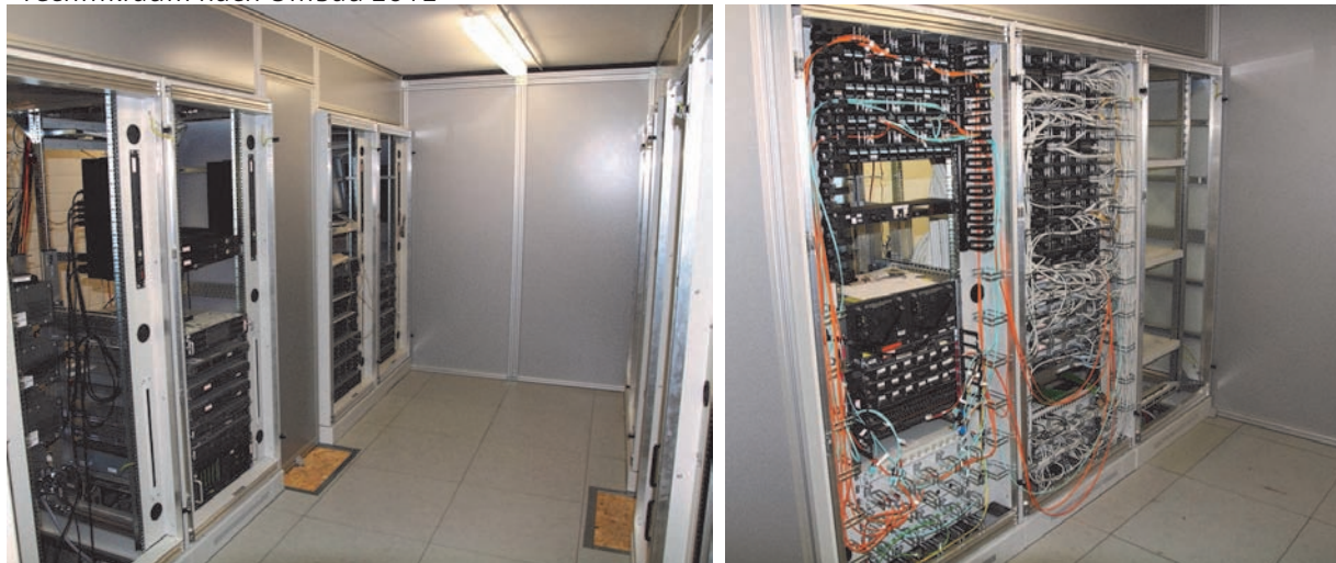
Technikraum nach Umbau 2012
