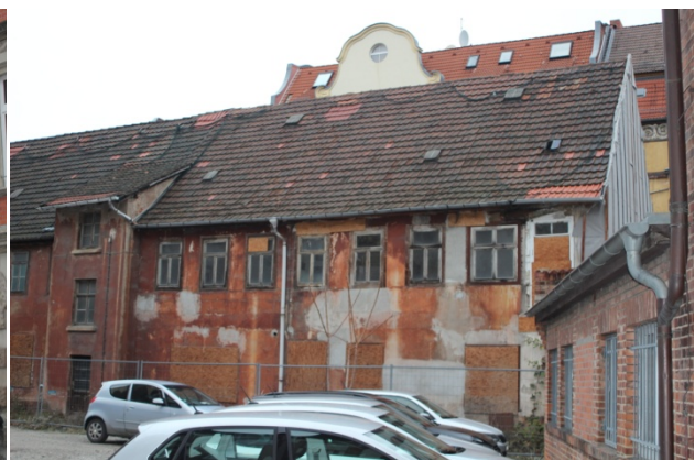
Abb. 2: Hofseitige Ansicht Gebäude Schmidtstedter Straße 38/39, über den Ziegeln liegt teilweise ein Netz als Absturzsicherung für lose Ziegel.
