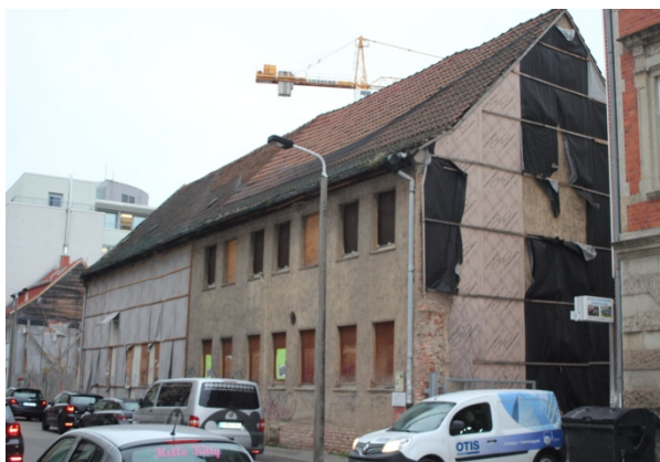
Abb. 1: Straßenseitige Ansicht Gebäude Schmidtstedter Straße 38/39 mit verbarrikierten Fenstern und mit Folie eingehausten Fassadenteilen.
