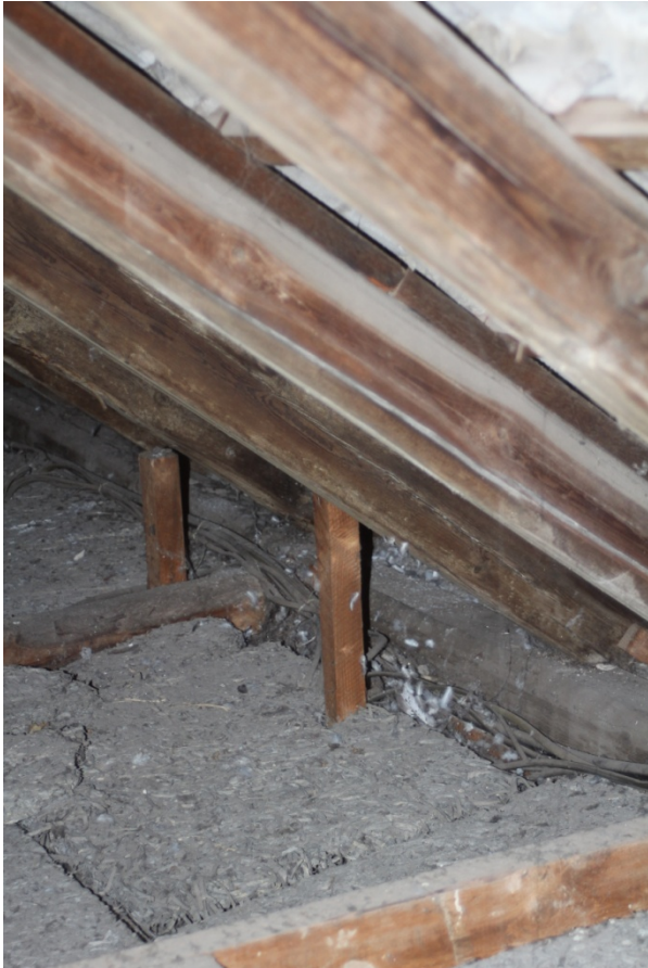
Abb. 10: Fraß- und Kotspuren vom Marder auf dem Dachboden.
