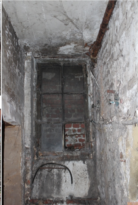
Abb. 5: Kellerfenster mit zerbrochener Scheibe von Innen vor dem vergitterten Kellerschacht.
