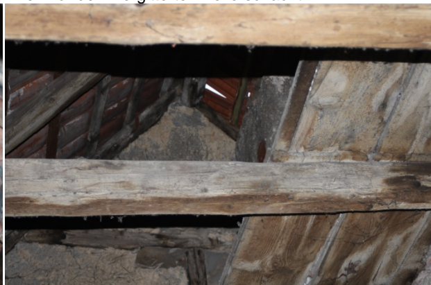
Abb. 7: Verrutschte Ziegel im Dach, deren Spalt als Einflugmöglichkeiten für Fledermäuse bietet.
