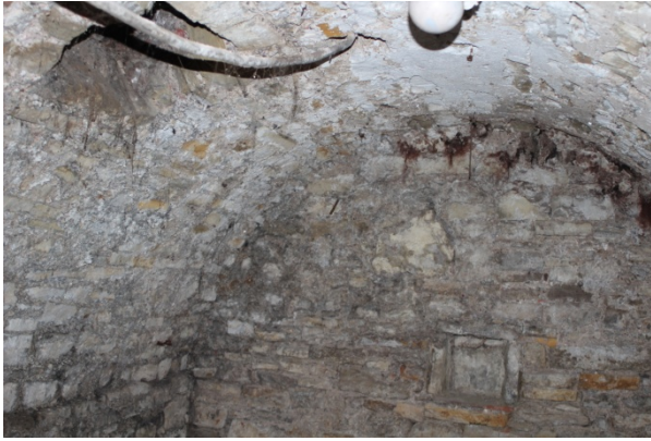
Abb. 3: Mittelalterlicher Gewölbekeller ist zu trocken zur Überwinterung von Fledermäusen.
