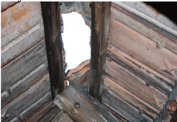
Abb. 6: Fehlende Ziegel im Dach durch die Fledermäuse in das Dach fliegen können.
