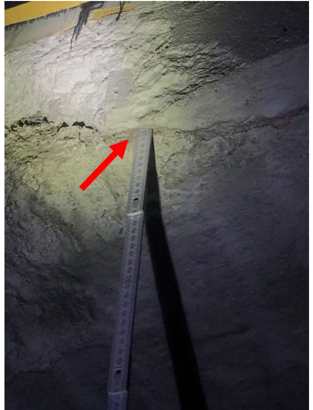
Abb. 27: Nach dem Verlassen der Fuge wurde diese am 06.05.20 vermessen: ca. 0,90m tief und 2,0m breit.
