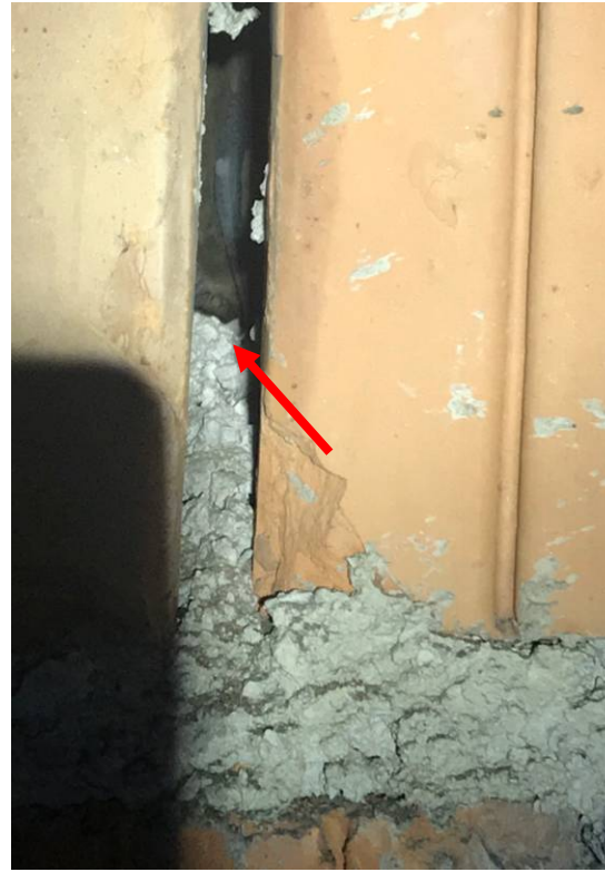
Abb. 15: Fugenspalte mit einer Zwergfledermaus besetzt (roter Pfeil)
