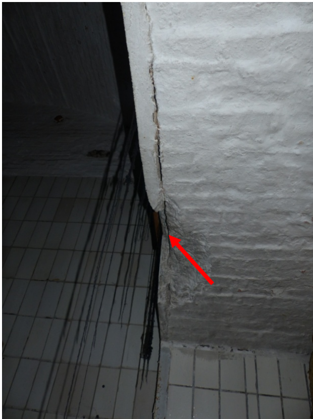
Abb. 8: Mit Zwergfledermäusen besetzte Fuge am 17.12.2019, Ansicht von unten, siehe roten Pfeil.
