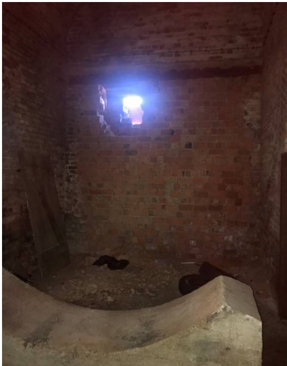
Abb. 16: Zweite Ziegelwand (Backsteinwand) Keller unter ehem. Pferdeställen mit zahlreichen Fugenspalten und Loch in der Doppelwand. In der inneren Ziegelwand hingen 3 Zwergfledermäuse.
