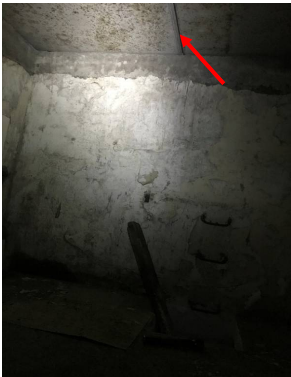
Abb. 12: Deckenhohlraum am Kellertreppenaufgang mit Betonfuge direkt unter der Asphaltfläche?
