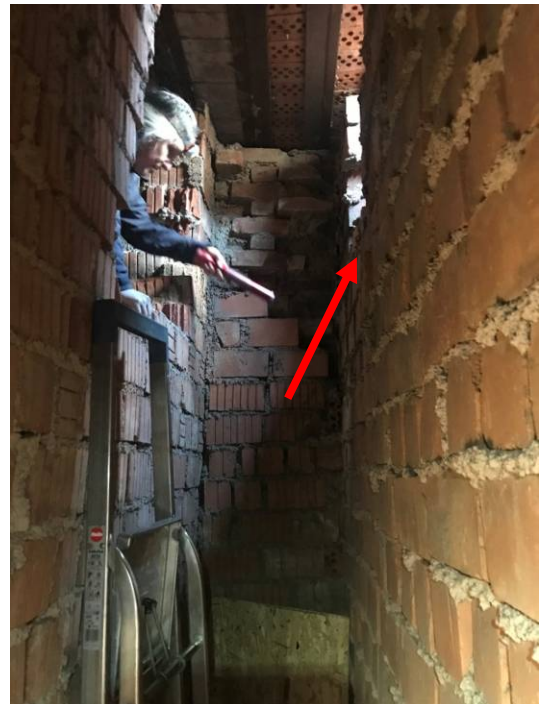
Abb. 17: Äußere Ziegelwand mit Fugenspalte, die mit einer Mopsfledermaus besetzt war (Hangplatz: roter Pfeil).
