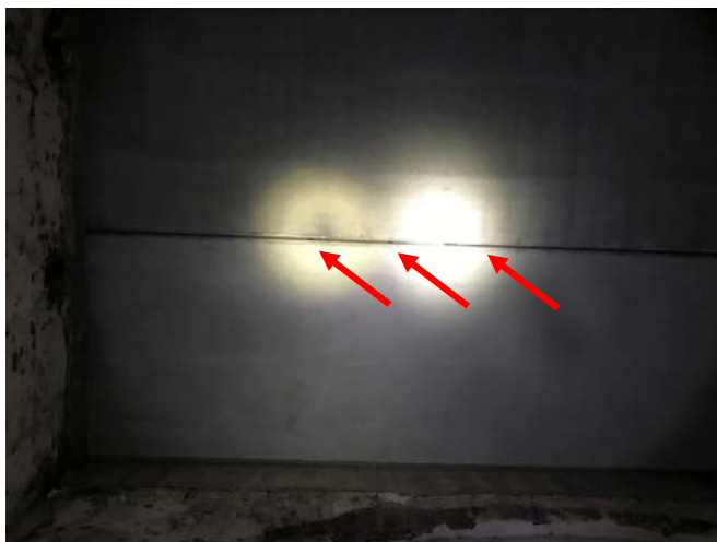
Abb. 20a: Am 04.01.21 neu entdeckter Hangplatz in der asphaltnahen Betondecke im Tonnengewölbe (Nr. 7 Abb. 25)
