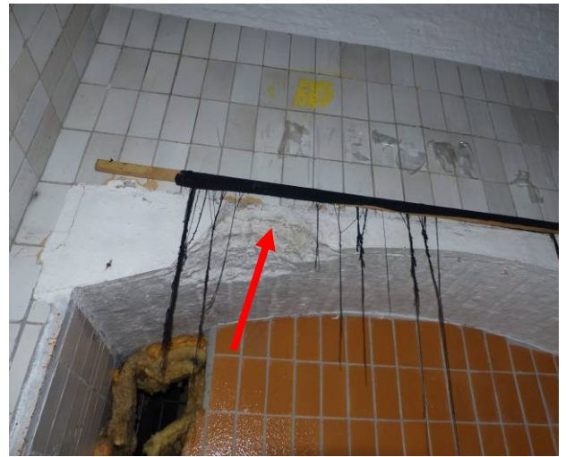
Abb. 7: Von Zwergfledermäusen besetzte Fuge am 17.12.2019, siehe roten Pfeil.
