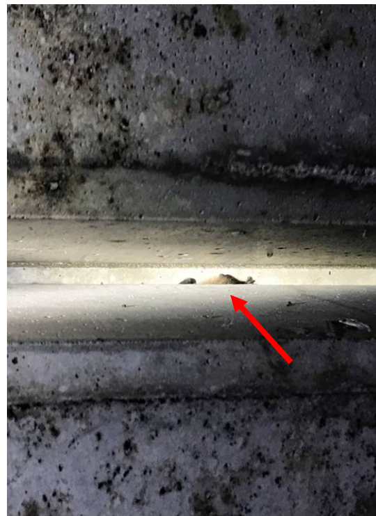
Abb. 13: Z.T. sichtbare Zwergfledermaus in dieser horizontalen Fuge die nicht weiter einsehbar war. Aufgrund der Soziallaute und vorhandener Kotpellets scheinen aber zahlreiche Tiere auch dort zu überwintern.
