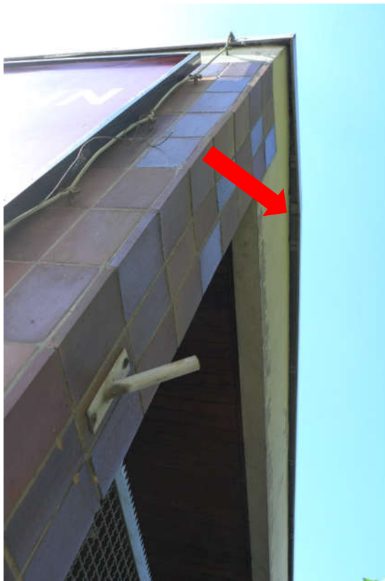
Abb. 10: Brutplätze Haussperling hinter Attikablech siehe roter Pfeil
