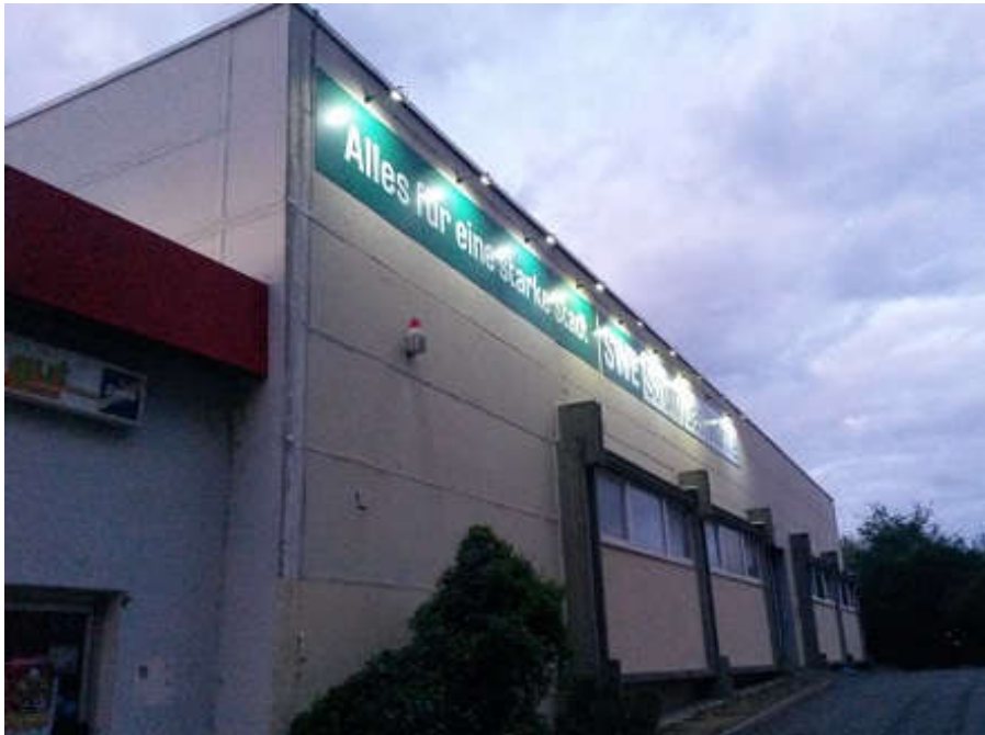
Abb. 12: Beleuchtete Werbung unterhalb von potenziellen Spaltenquartieren am Attikablech
