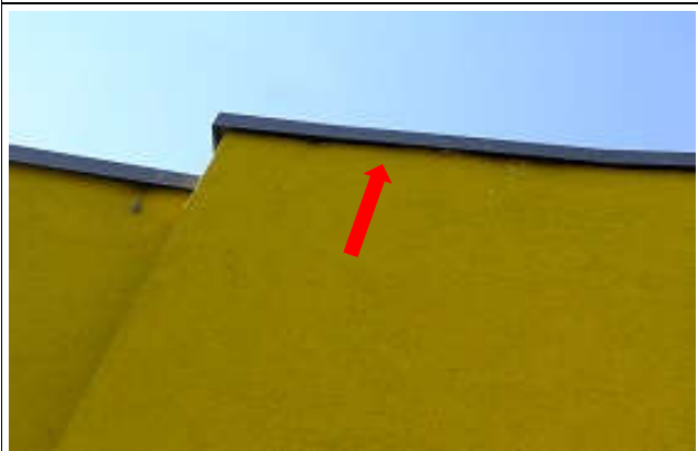
Abb. 8: Spaltenquartiere unter Attikablech (roter Pfeil)
