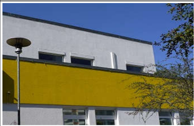
Abb. 9: Spaltenquartiere unter Attikablech
