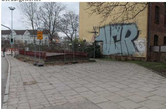
Fehlende Anbindung des Quartiers an die nordöstlich angrenzenden Stadtteile / Bauzustand der Gehwege mangelhaft / Funktionsverlust der Querungsstelle Trommsdorffstraße
