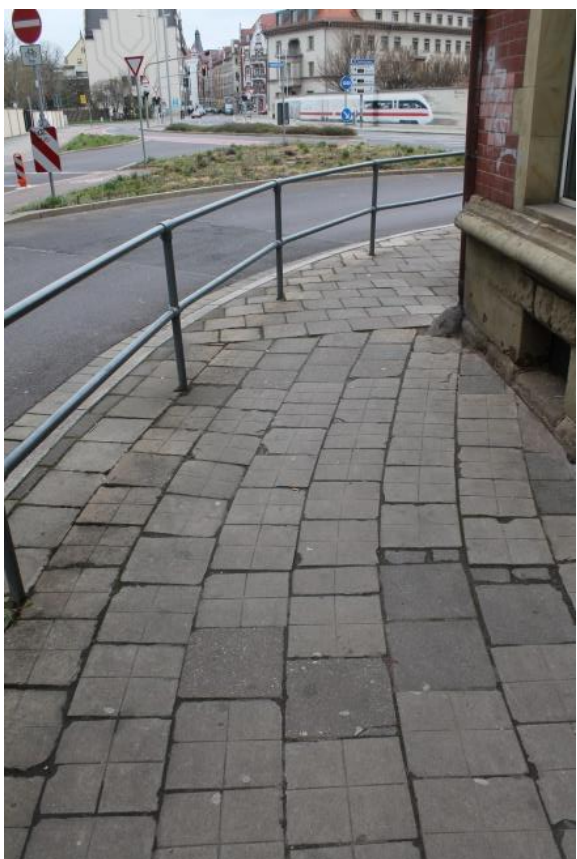
Schlechter Bauzustand der Gehwege in der Trommsdorffstraße / stark beengte Fußwege
