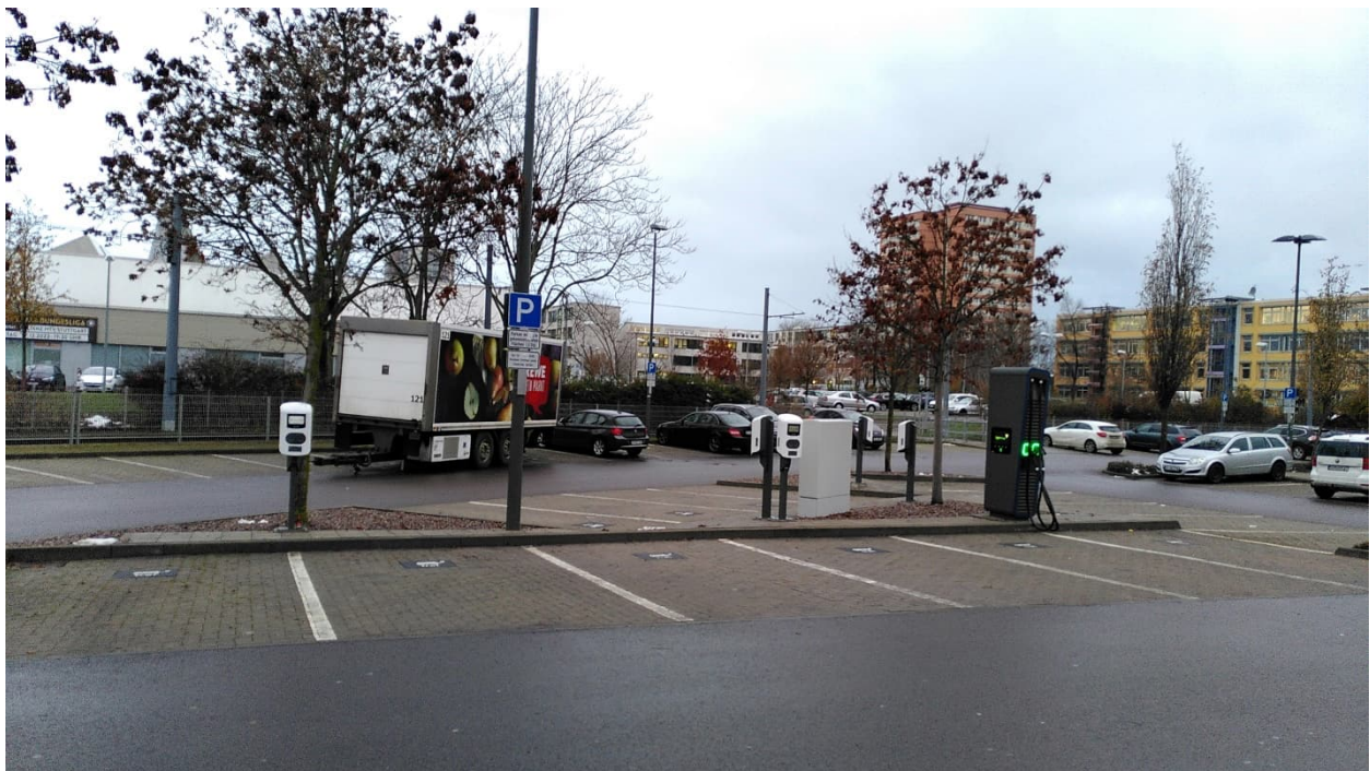
Foto 5 Kundenparkplatz mit Ladeinfrastruktur im Rieth
