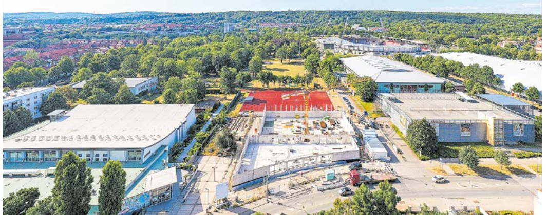
Die Drei-Felder-Halle in der Johann-Sebastian-Bach-Straße nimmt Gestalt an. Sie wird Kapazitäten für Schul- und Vereinssport bieten.
